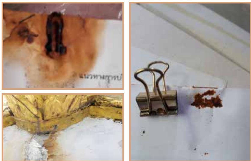
สนิมเหล็กทำให้เกิดคราบ เปื้อนสีเข้มบนวัสดุอื่น ๆ ที่อยู่ใกล้
